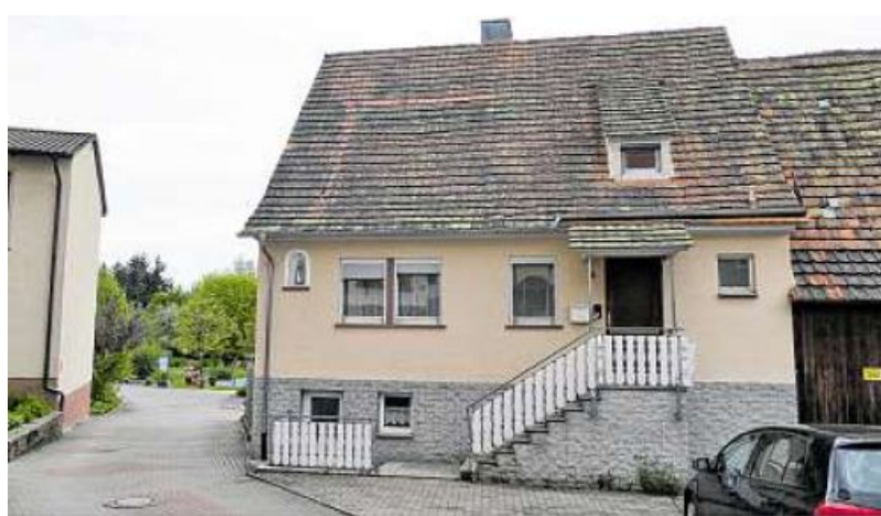
Das Gebäude in der Hauptstraße wird abgerissen, wenn absehbar ist, dass der Neubau für die Tagespflege zeitnah erfolgt. Foto: Susanne Feistle
